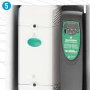
New VSD cubicle
